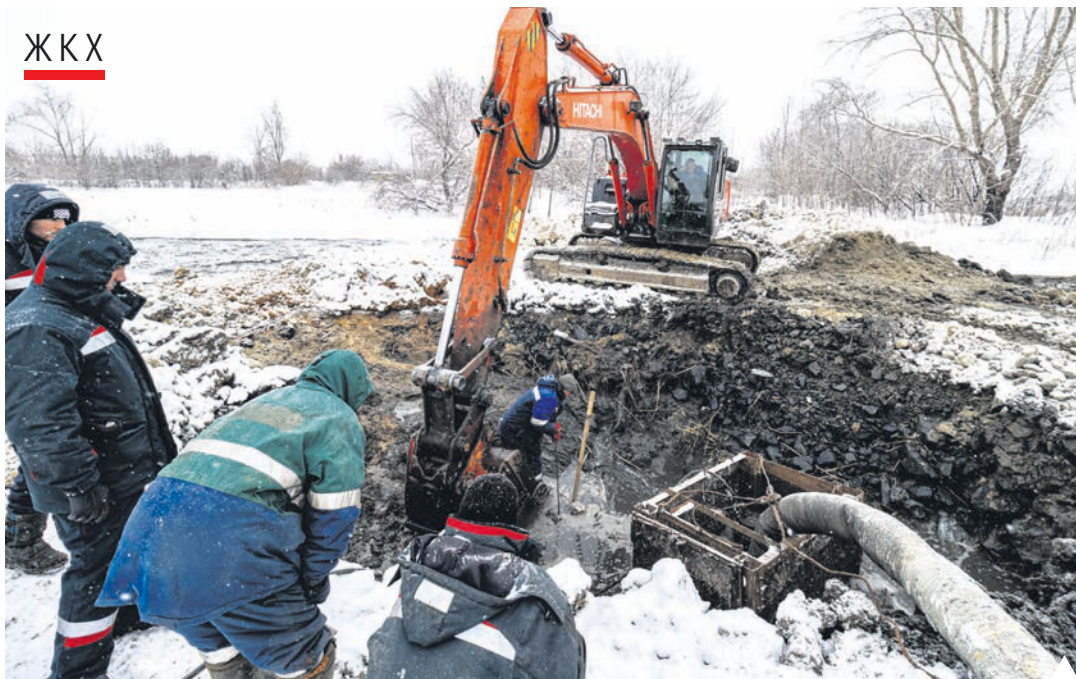
Подрядчики заменили два метра пластиковой трубы коллектора диаметром 160 миллиметров | Фото Кирилла Васильева
