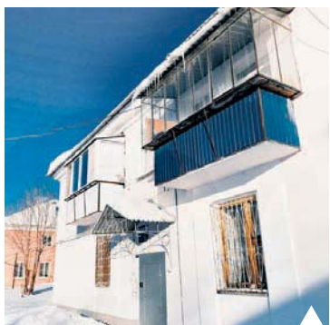
За козырьки застеклённых балконов отвечают собственники
