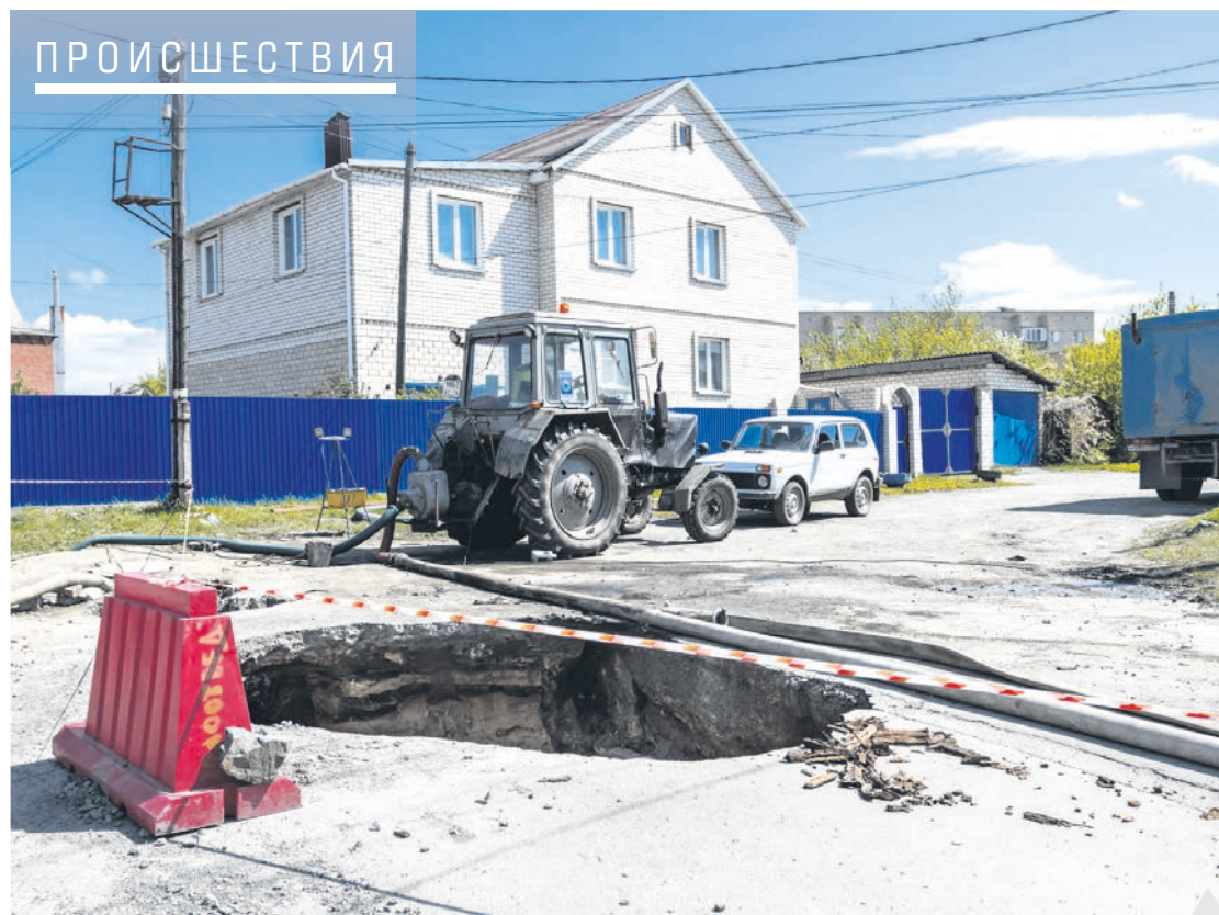
Ведётся круглосуточное откачивание сточных вод | Фото Кирилла Васильева
