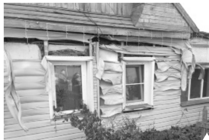
Сайдинг на доме оплавился от высокой температуры | Фото из архива 107-й ПЧ
